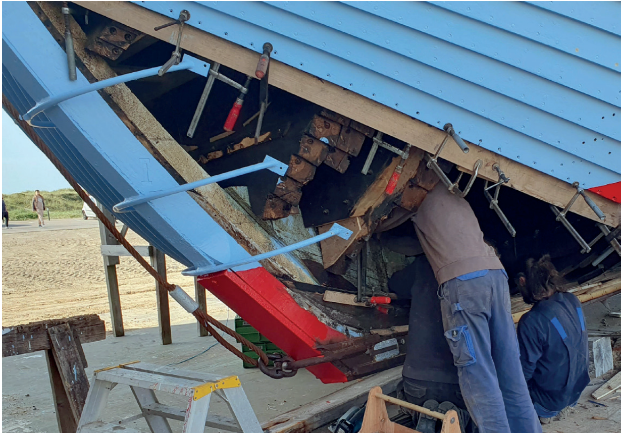
Det var et anseeligt hul i stævnen på Kikani, der skulle repareres. Foto: Pipsen
